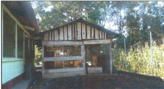
Foto 3: Se observa el deterioro portante de la cocina del modulo 1
